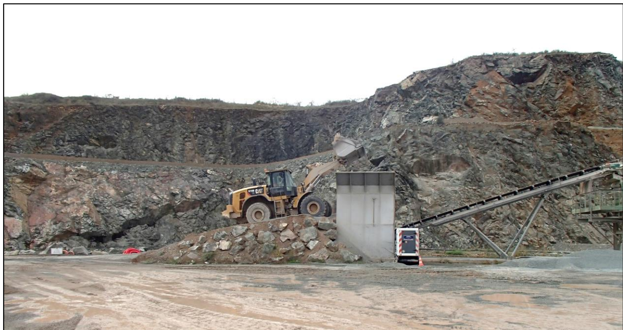
Figure 38 - Alimentation de la trémie de l'installation de lavage des matériaux
