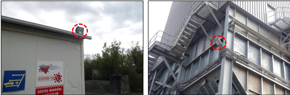
Figure 50 - Eclairages installés sur la carrière
