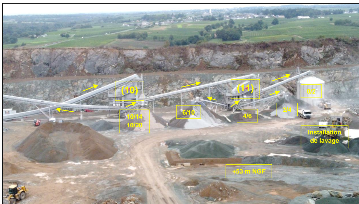
Figure 35 - Vue sur la partie tertiaire de l'installation de traitement
