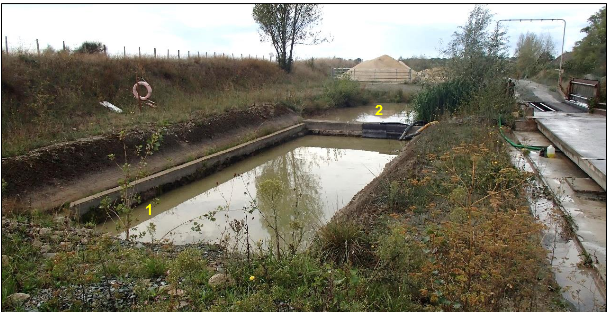
Figure 24 - Bassins des eaux de procédé du dispositif lave-roues et de la rampe d'arrosage
